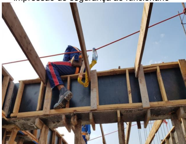
Figura 10 – Linha de vida executada de forma inadequada, causando falsa impressão de segurança ao funcionário
